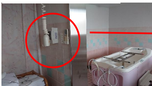
浴室までコンセント引っ張れます 医療機械つけてシャワーOK
